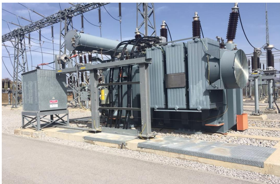
Фигура 3.4.1 Силов трансформатор в подстанция Gjilani 5.
